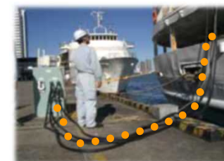
電力供給設備
